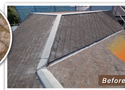
変色・腐食した屋根
